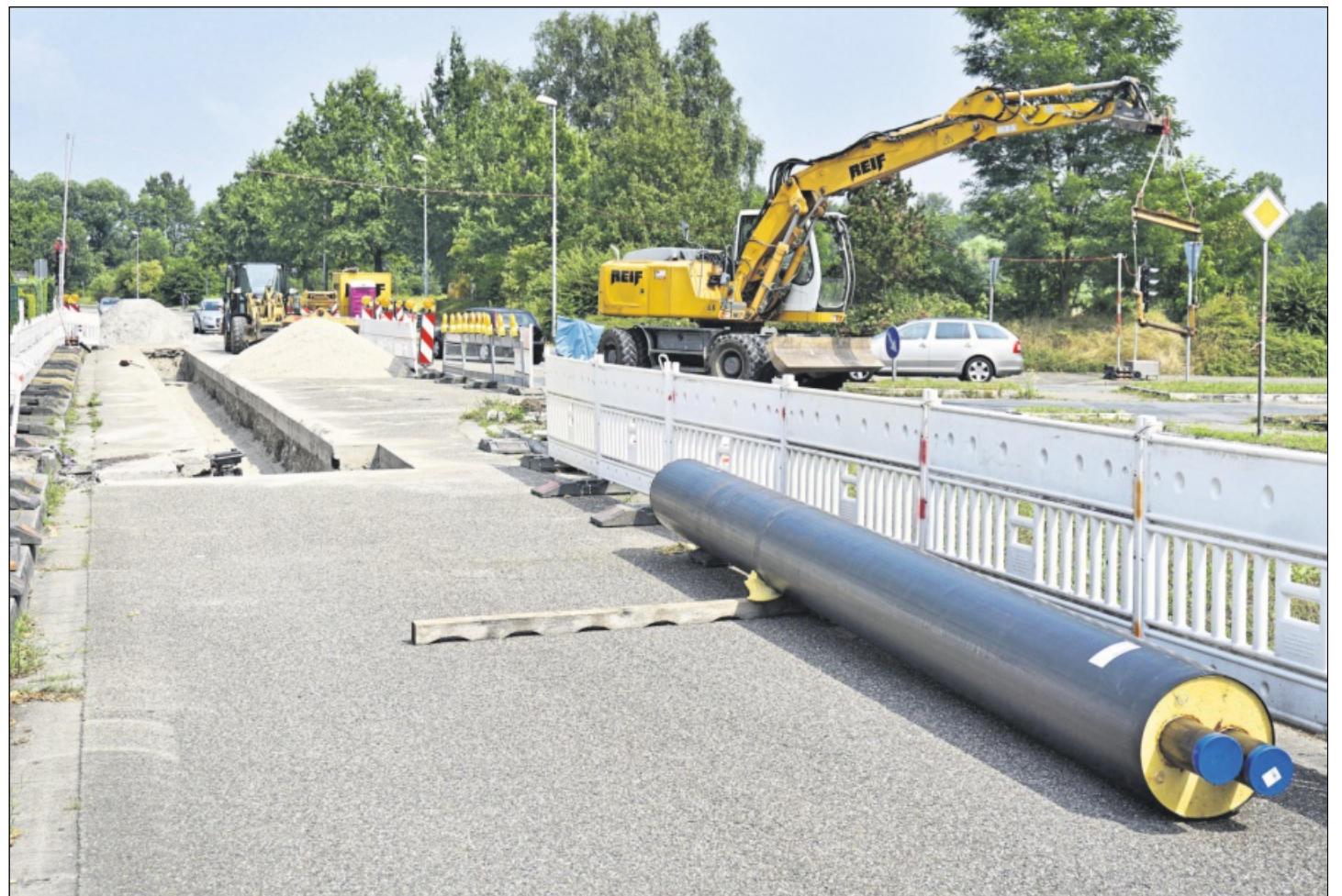
ROHRE FÜR NAHWÄRME haben die Stadtwerke im Sommer im Röderweg verlegt. Innerhalb der nächsten drei Jahre könnte das Nahwärmenetz in Rastatt noch weiter wachsen. Archivfoto: Collet
